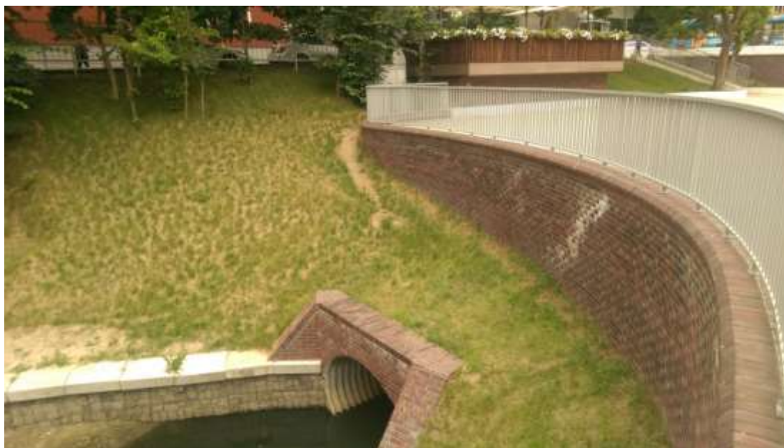
Рис. 3. Вид на закрытый коллектор на пересечении проспекта Мира и ул. Колоскова (июнь 2018 г.)
