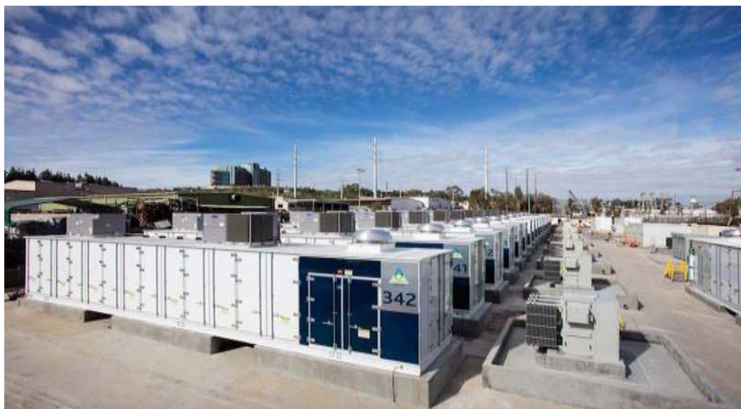
Рис. 4. Накопитель компании San Diego Gas & Electric (SDG&E) (Калифорния) на основе литий-ионных аккумуляторов
