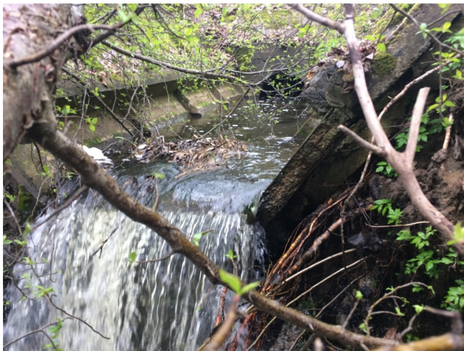
Рис. 1. Разрушенный лоток быстротока (апрель 2018 г., фото автора)
