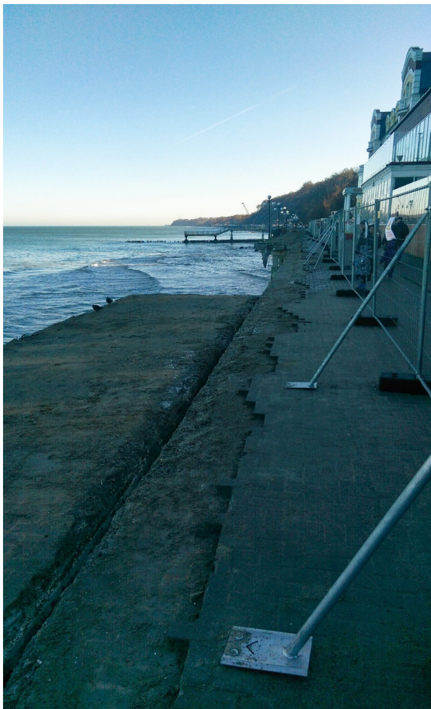
Рис. 2. Разрушенная часть променада морского побережья в районе г. Светлогорска Калининградской области
