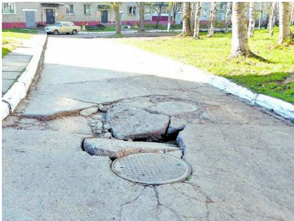
Рис. 2 Провал асфальта между двумя колодцами на проезжей части улицы города Кирово-Чепецка [4]
