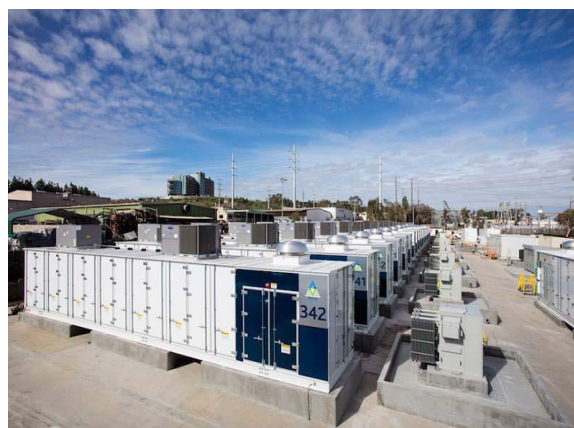
Рис. 10. Накопитель на основе литий-ионных аккумуляторов мощностью 30 МВт
