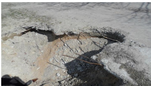
Рис. 3. Разрушение дорожного полотна в результате эрозионных процессов
