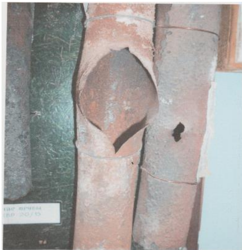
Рис. 2. Разорванная труба переднего бокового экрана. 16 ая труба в ряду от 10 ой по 20 ую трубу.
