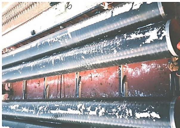
Рис. 3 Повреждённые трубы большого диаметра
