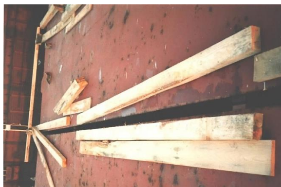
Рис. 4 Дефекты сепарации под трубы большого диаметра
