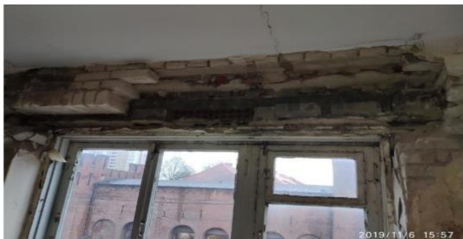
Рис. 4. Надоконная часть стены без перемычек
