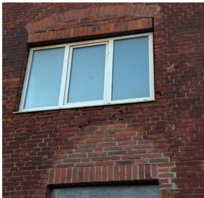
Рис. 3. Трещины в наружной стене «Дома пожарных» в г. Калининграде
