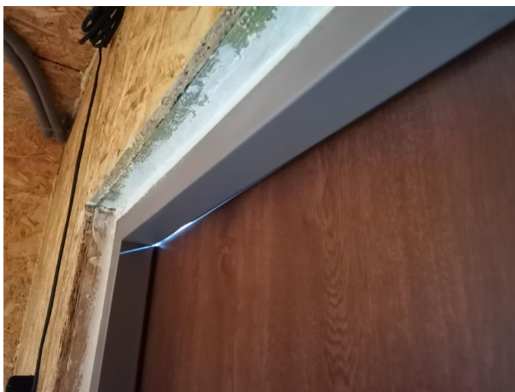
Рис. 5. Неплотный притвор двери.
