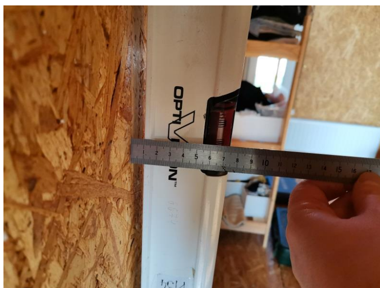
Рис. 12. Наклон стены здания.
