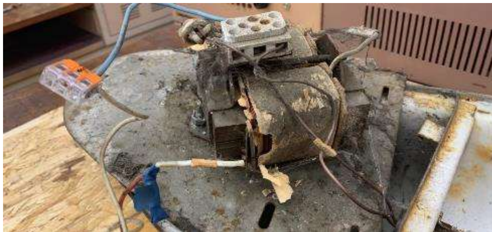
Рис. 5. ПРА устаревшего светильника РКУ 125
