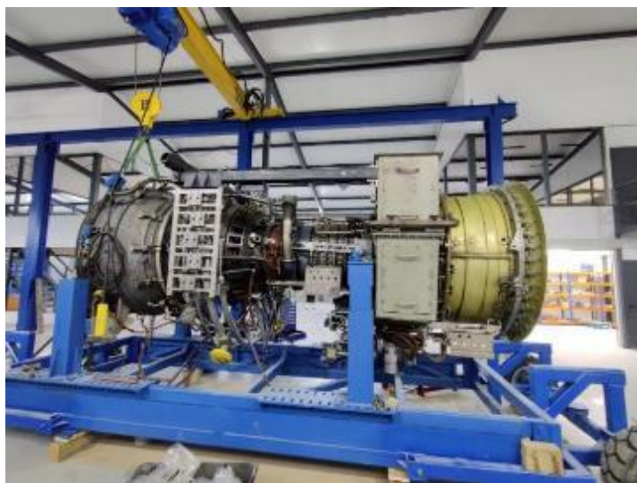
Рис. 1 Газовая турбина LM6000 на объекте ООО «БЭМ»
