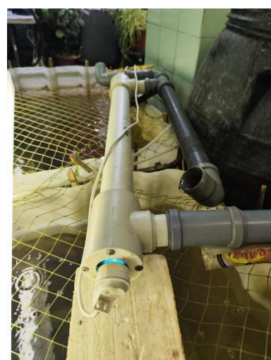
е) система трубопроводов и УФ обеззараживание
