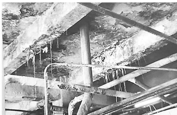
Рис. 6. Щелочная коррозия бетона балок и плит
