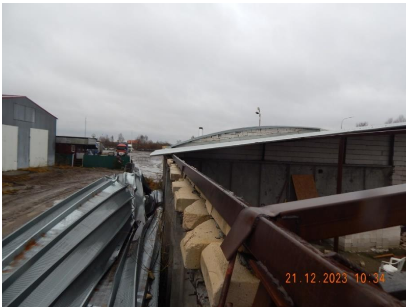
Рис. 4. Отсутствие армирующего пояса.
